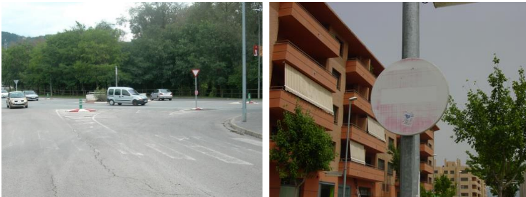
Imatge 67. Senyalització en estat deficient
